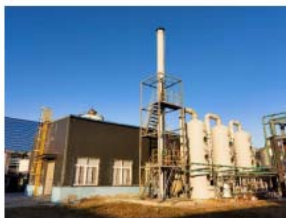
危废库废气治理设施
