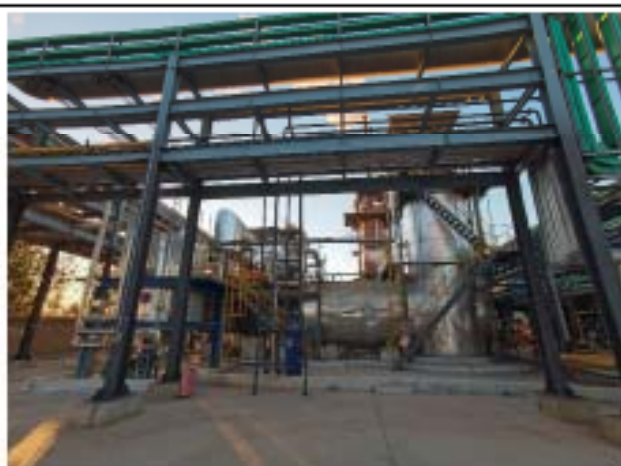
废气废液焚烧炉
